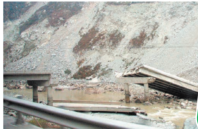
在阿坝州道上的一座断桥。
